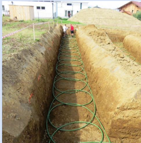
Wärmepumpe mit Ringgrabenkollektor
